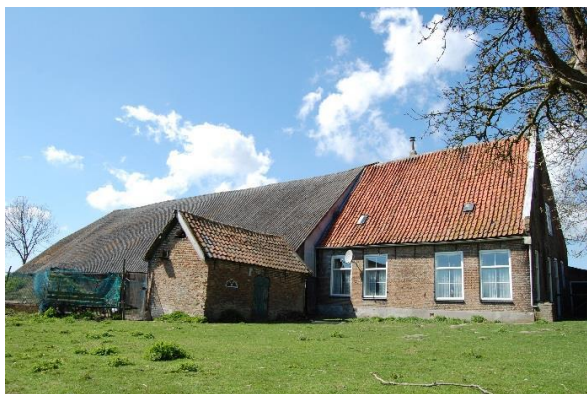
Asbestsanering van grote dakoppervlakten, zoals in het geval van de landbouwschuur van De Grote Mouterij in Sint-Maartensdijk, confronteert de eigenaar met hoge kosten.
