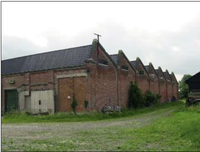
De voormalige tramremise op 15 juni 2007. Tussen 1951 en 2008 deed het gebouw dienst als opslagloods voor aardappelen en uien.
