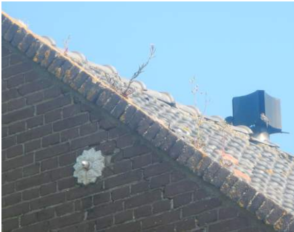
Slechte staat dakrand
