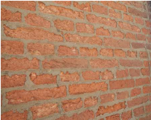
Slecht uitgevoerd voegwerk
