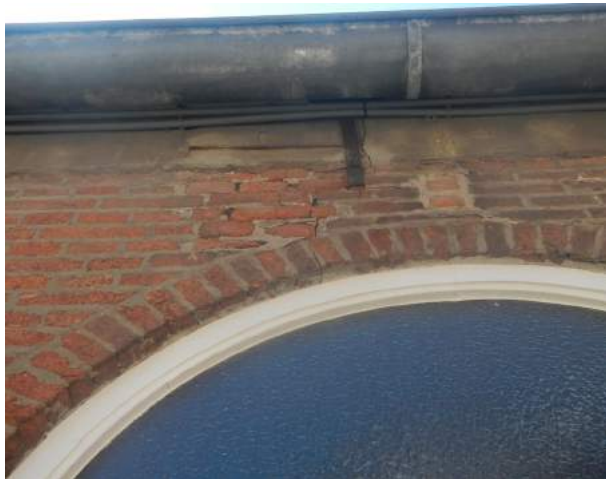
Scheurvorming boven venster
